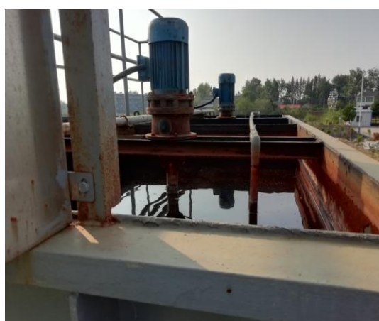
混凝沉淀池 T6-T8
