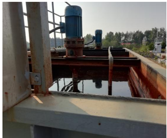
混凝沉淀池 T6-T8
