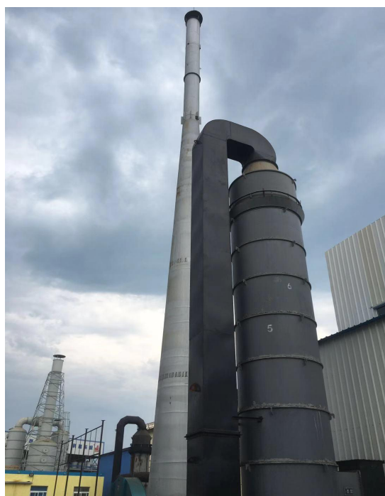
锅炉水膜除尘器（废气处理设施）
